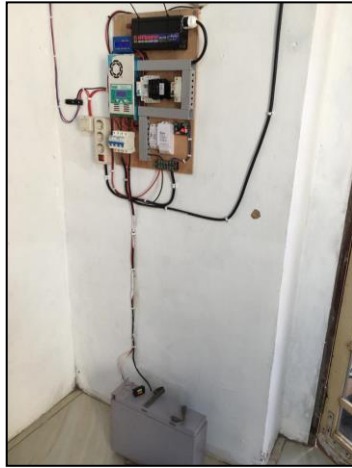
Gambar 7. Panel kendali dan baterai yang telah terhubung dengan panel surya
